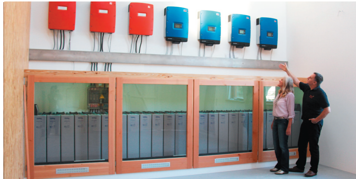
Sieht aus wie aneinandergereihte Kühlschranks, ist aber ein Stromspeicher. Lisa und Gerhard Steber verfügen mit ihrem System über den wohl größten Stromspeicher Schwabens. Ganz billig war die Anlage nicht. Allein für die Speicher investierte das Ehepaar 45 000 Euro, für die Notstromversorgung kamen weitere 11 000 Euro hinzu.
